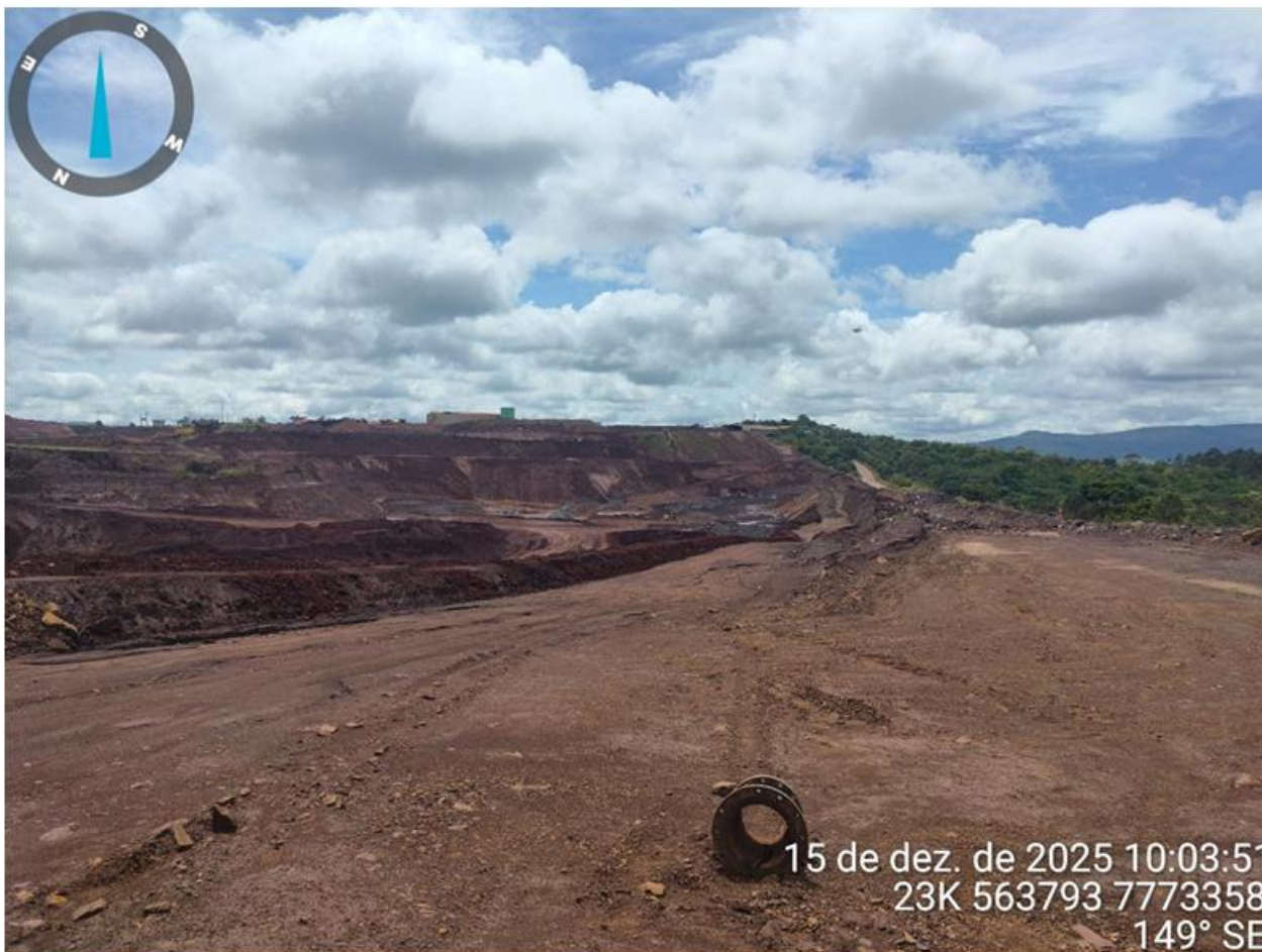
Figura 6.2: Visão da região do reservatório e do reforço de itabirito a partir da ombreira direita. Fonte: SAFF-MIN002-RT-004-R1 (SAFF, 2025).
